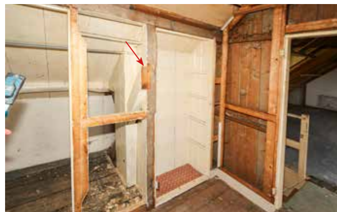
middelste zolder met afgezaagd spantbeen (pijl)
