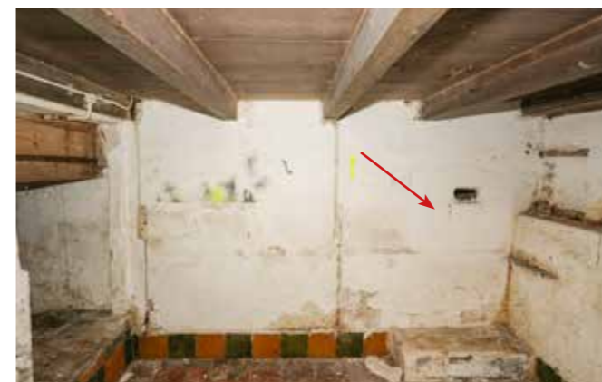
kelder richting zuiden, achter de muur met de pijl ligt de trap
