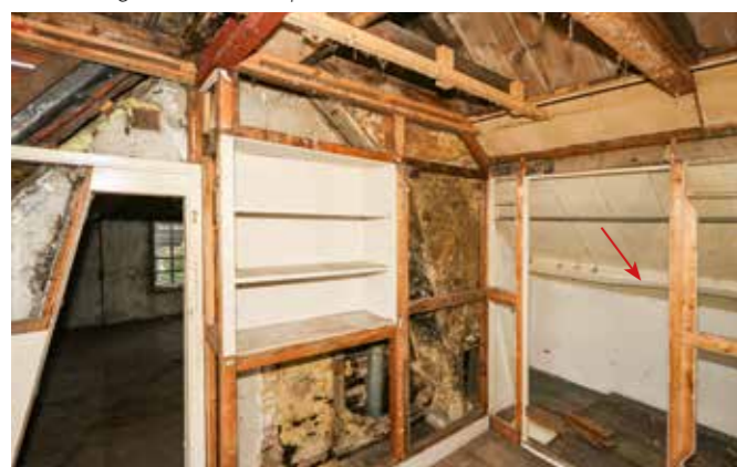
middelste zolder met verslechte schoorsteen, rechts afgeronde gording
